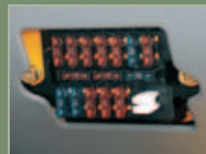
Scentralizowana skrzynka bezpieczników zapewnia łatwe przeprowadzenie przeglądów
